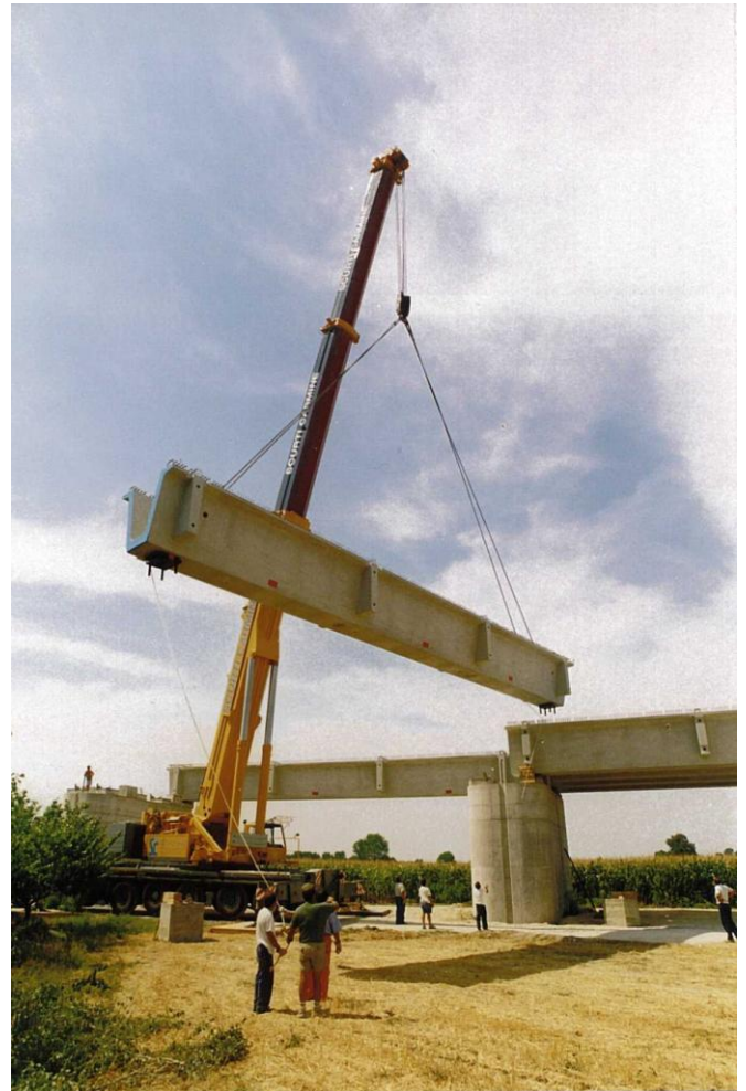
Fig. 7 Posa di travi da ponte per la linea ferroviaria ad alta velocità Roma-Napoli
