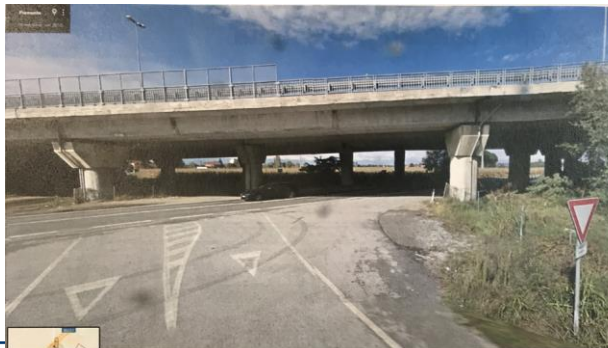
Situazione Ante Crollo
