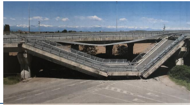
Situazione Post Crollo (Attuale)
